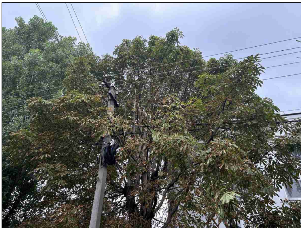
Опора № 13 ВЛ-0,4 кВ «Р. Люксембург нечетная», присоединенная к ТП 6/0,4 кВ «РГ-1-215», совместный подвес с ВЛ-0,22 кВ «Наружное освещение» присоединенной к ТП 6/0,4 кВ «РГ-3-5»
